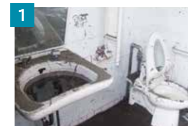
1 既存トイレは全く使用できない状況でした。
